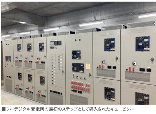
■フルデジタル変電所の最初のステップとして導入されたキュービクル
