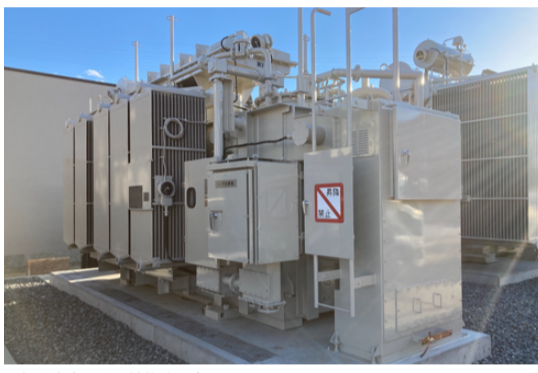
■新大岩変電所の植物油入変圧器
