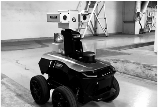
▲ 堺港発電所で実証実験を行っている巡視点検ロボット
