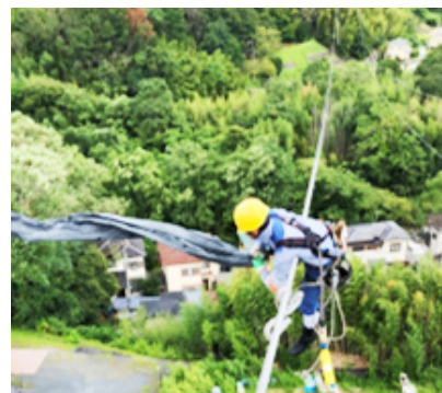
送電線の飛来物除去
