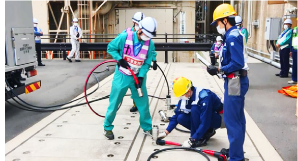
中国電力からの高圧電源車搬送・接続訓練
