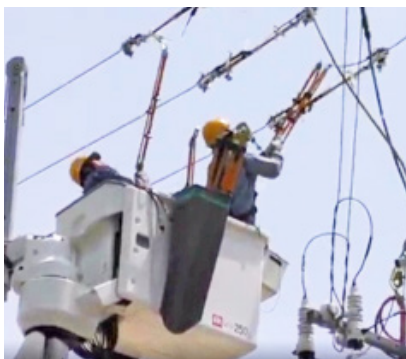
災害に備えた電力復旧訓練
