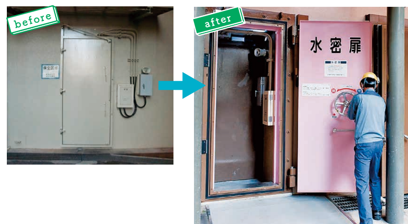
水密扉の設置
