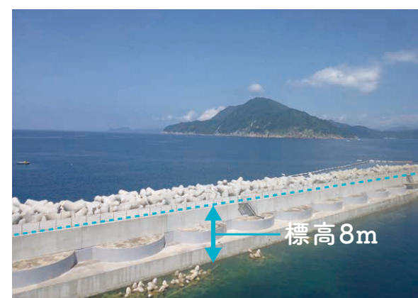
防波堤のかさ上げ
