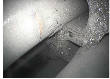
(A-SG第6管支持板のきずの状況)
