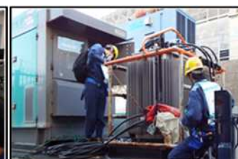
電源車実動訓練
