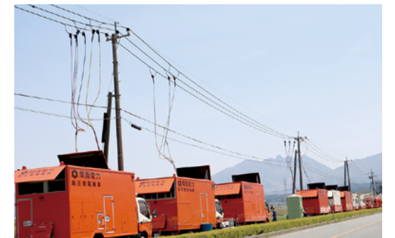
応急送電をおこなう高圧発電機車（イメージ）（2016年4月）
