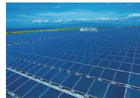
2011年 メガソーラー堺太陽光発電所営業運転開始 国内電力会社として初めて大規模太陽光発電所の運転を開始
