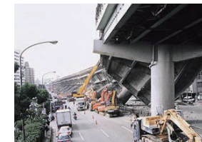
1995年 阪神淡路大震災における復旧活動 約260万軒の停電が発生。全社総動員で早期復旧に取り組み
