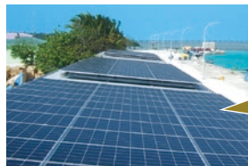
モルディブ・ディフシ島に譲渡した太陽光発電設備
