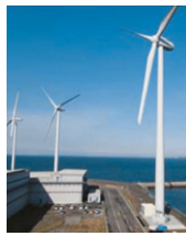
田原4区風力発電所
