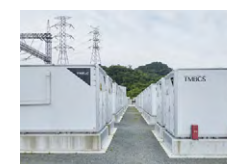
紀の川蓄電所 (2024年運転開始)
