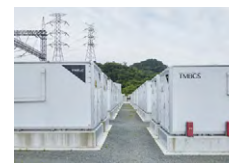
紀の川蓄電所 (2024年運転開始)
