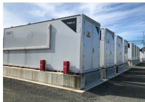
当社開発の系統用蓄電池の例（紀の川蓄電所）
