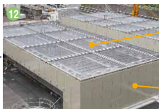
竜巻飛来物対策設備
