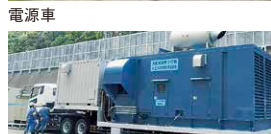
空冷式非常用発電装置
