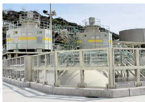
海水ポンプ周りの防護壁 (高浜発電所)
