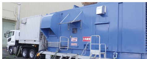
空冷式非常用発電装置の設置
