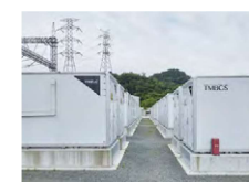
紀の川蓄電所 (2024年運転開始)
