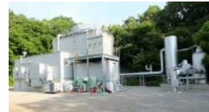
わいた発電所
