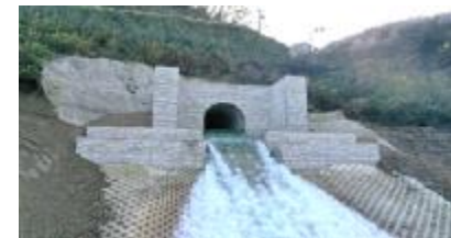
加須良川引水設備
