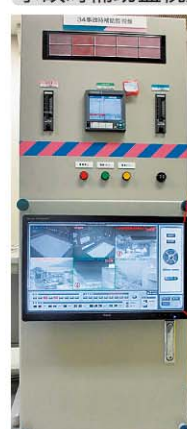
事故時補助監視盤
