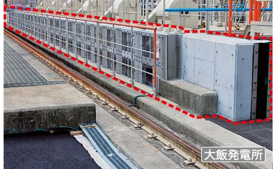
取水設備まわりの防護壁(標高6m)
