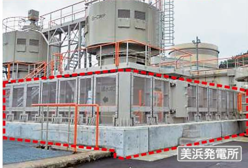
取水設備まわりの防護壁(標高6m)
