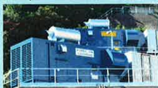
空冷式非常用発電装置
