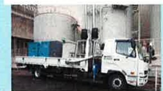
仮設中圧ポンプ
