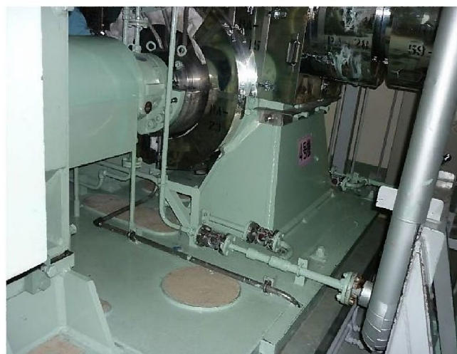
図18-2 4A, 4B余熱除去ポンプ 外観
