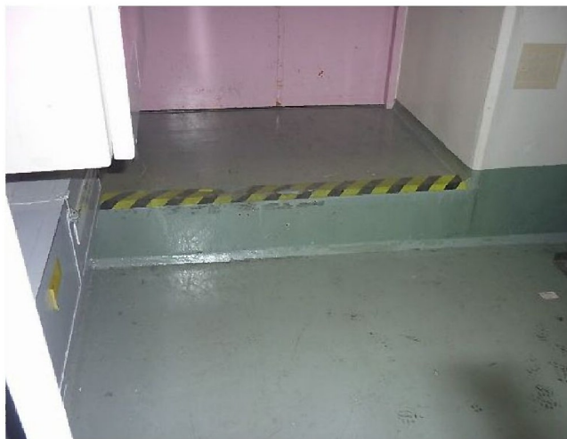
図18-4 4A, 4B余熱除去ポンプ 部屋入口の線
