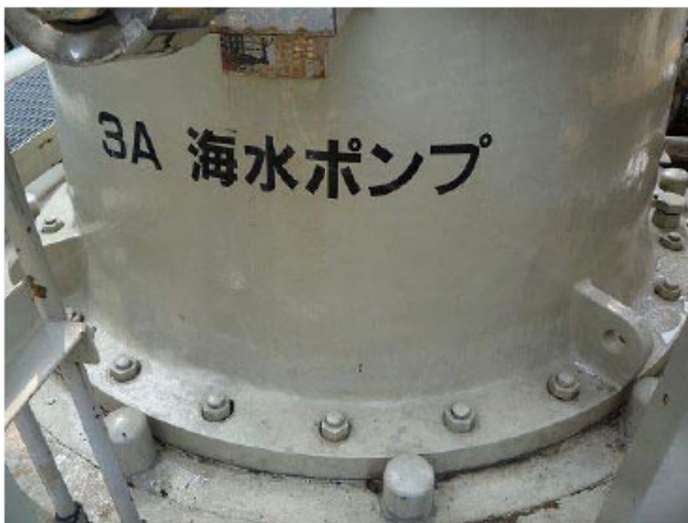
第 1.2.2.a-4 図 現場機器 (例 海水ポンプ)
