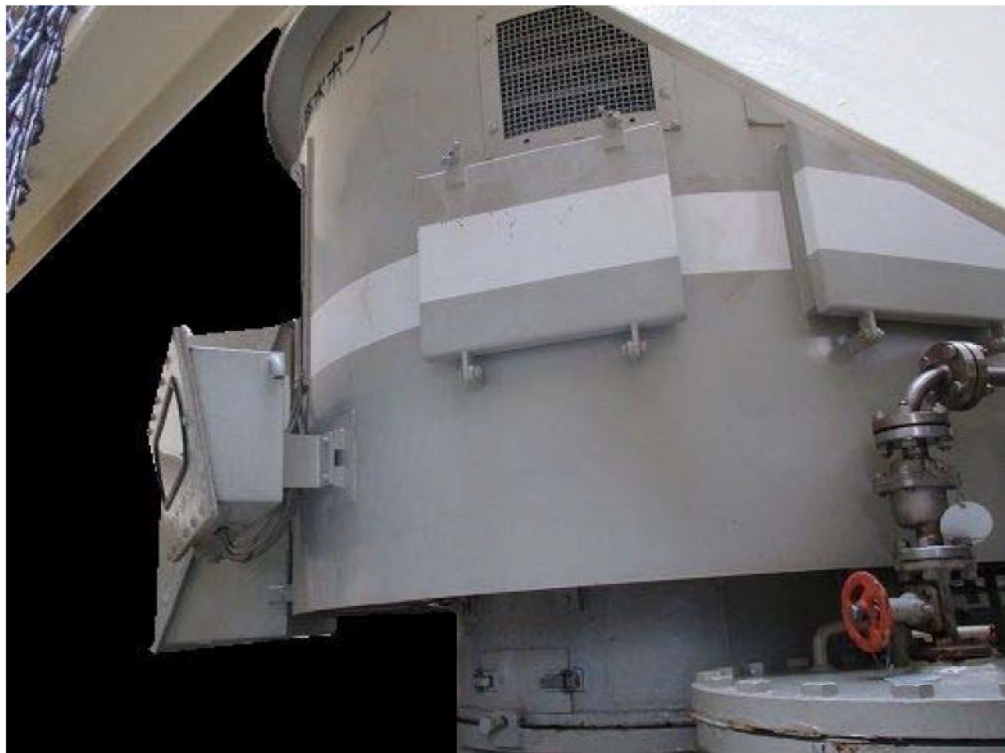
第 1.2.2.a-4 図 現場機器（例 海水ポンプ）
