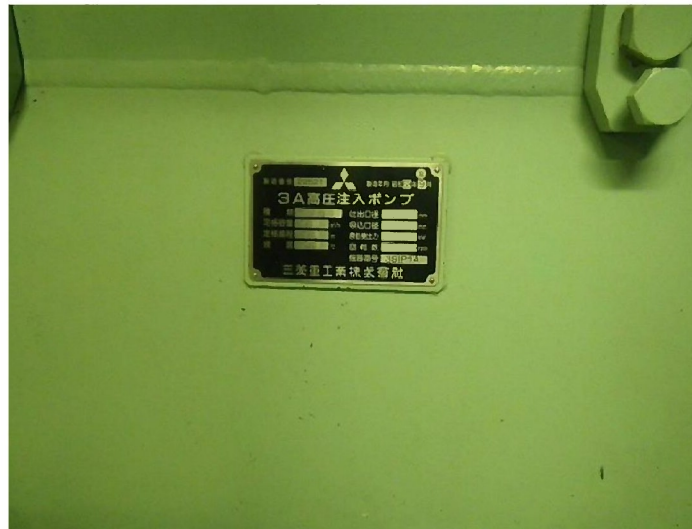
図 36-1 3A,3B 高圧注入ポンプ 機器名表示
