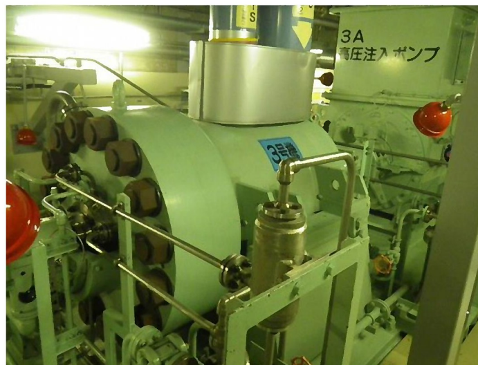
図 36-2 3A,3B 高圧注入ポンプ 外観
