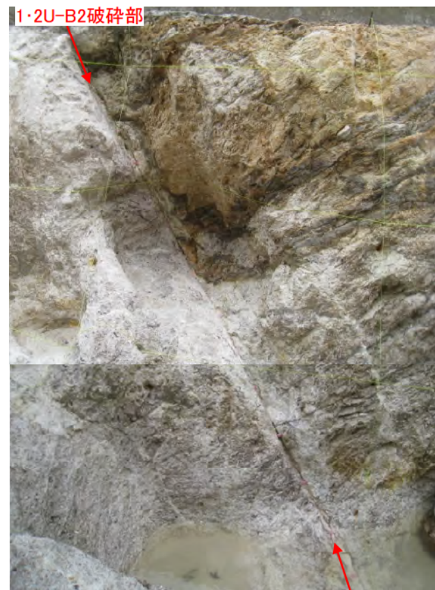
1・2U-B2破碎部山側壁面の写真
