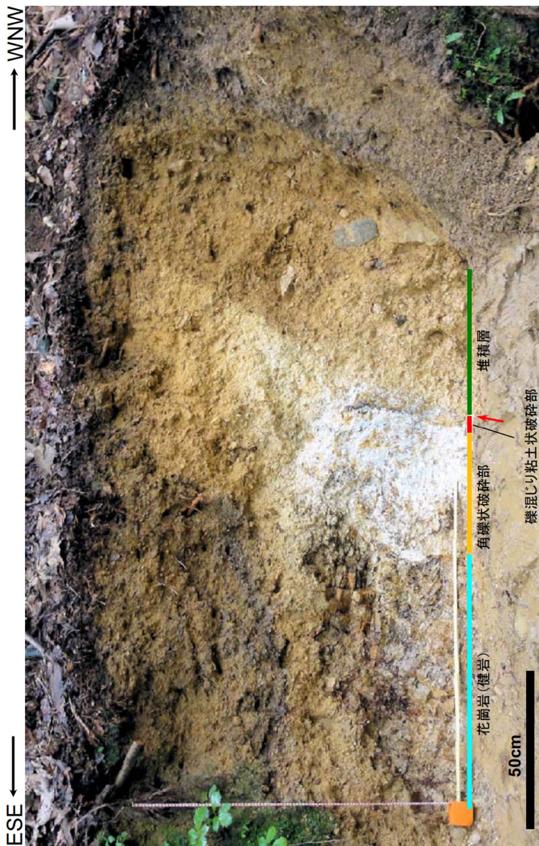
花崗岩と堆積層の境界に断層が認められる。花崗岩には幅約50cmの破砕帯が分布し、主断層面付近に幅約5cmの礫混じり粘土状破砕部を伴う。
