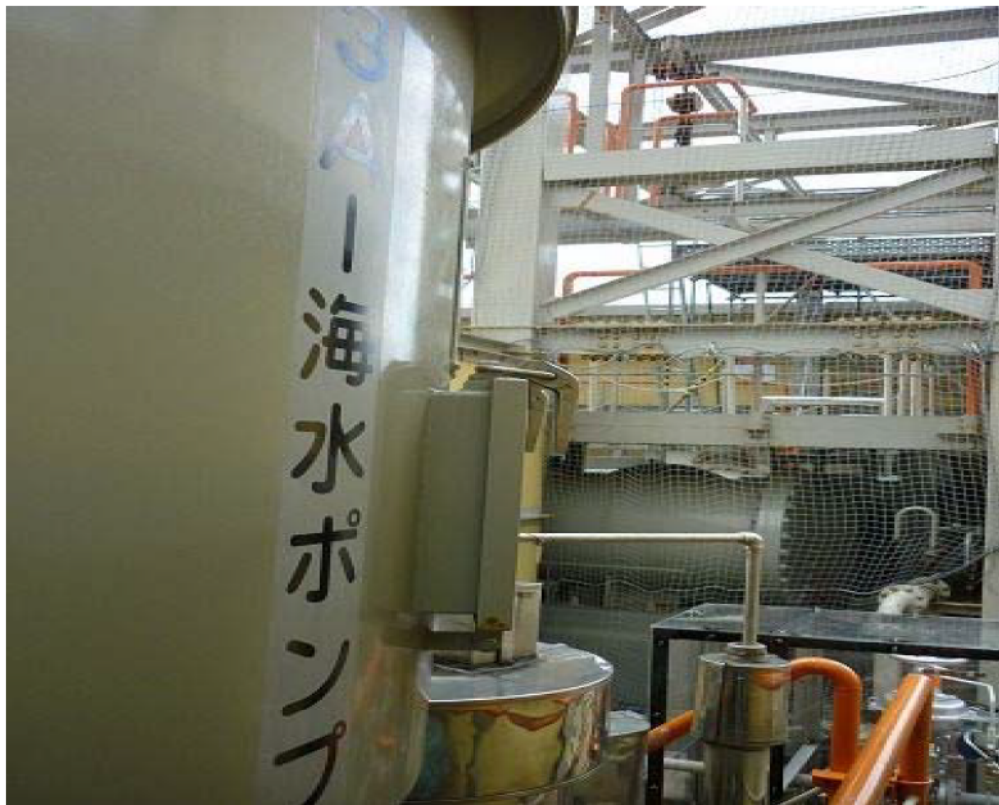
第 1.2.2.a-4 図 現場機器（例 海水ポンプ）
