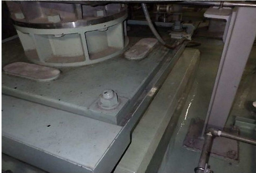
図 2-3 内部スプレポンプモータ 漏洩拡大防止措置
