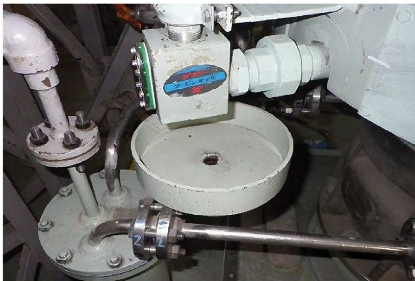
図 2-4 内部スプレポンプモータ 漏洩拡大防止措置
