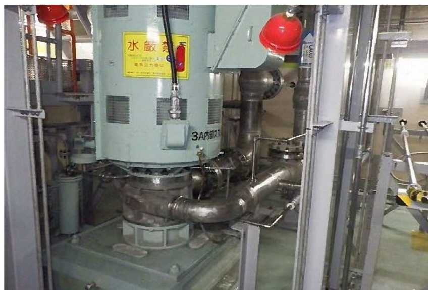
図 2-2 A～D 内部スプレポンプモータ 外観
