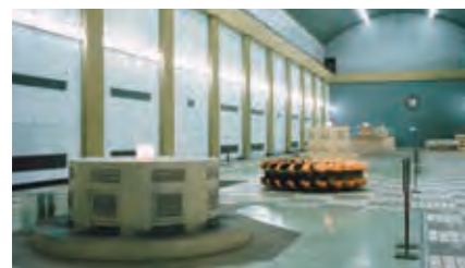
地下発電機室
