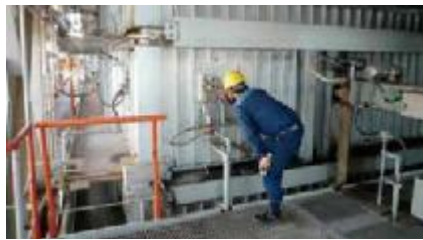
火力発電所の巡視点検
