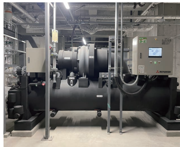
グラングリーン大阪で導入した帯水層蓄熱
