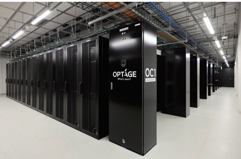
オプテージ曾根崎データセンター(OC1)サーバールーム
