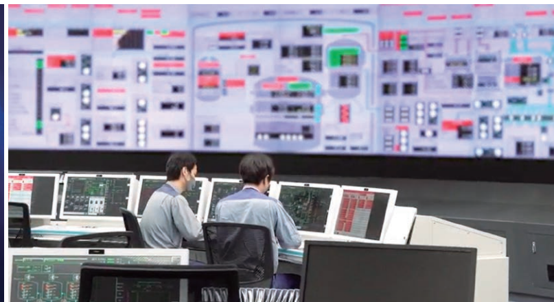
24時間体制でプラントの状態を監視(美浜発電所3号機の新制御盤)
