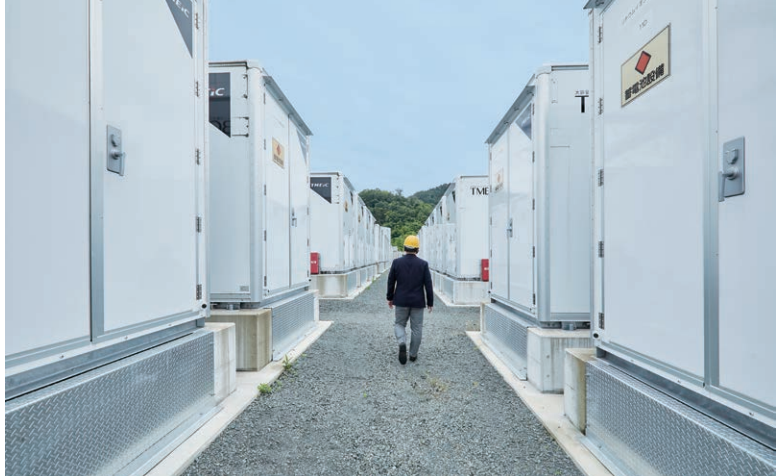
紀の川蓄電所（和歌山県）
