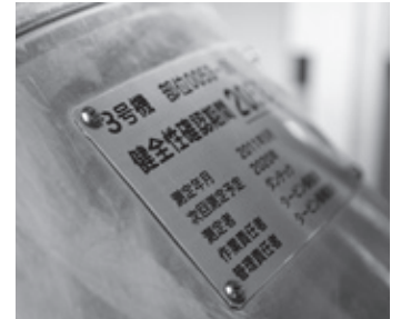
配管に留められたプレート
