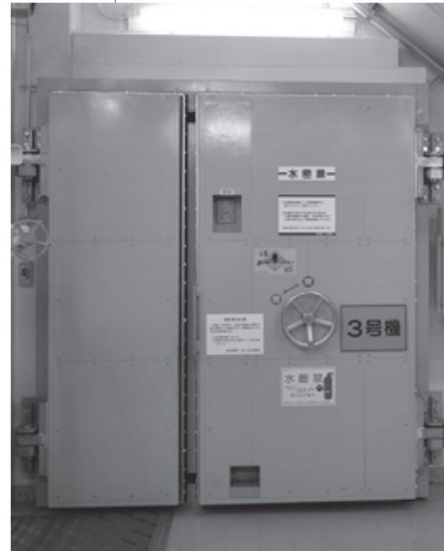
重要設備を浸水から守る水密扉
