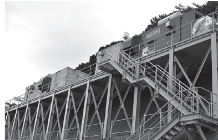
標高42mの高台に配備された空冷式非常用発電装置
