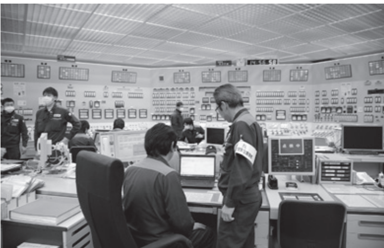
3号機の中央制御室
