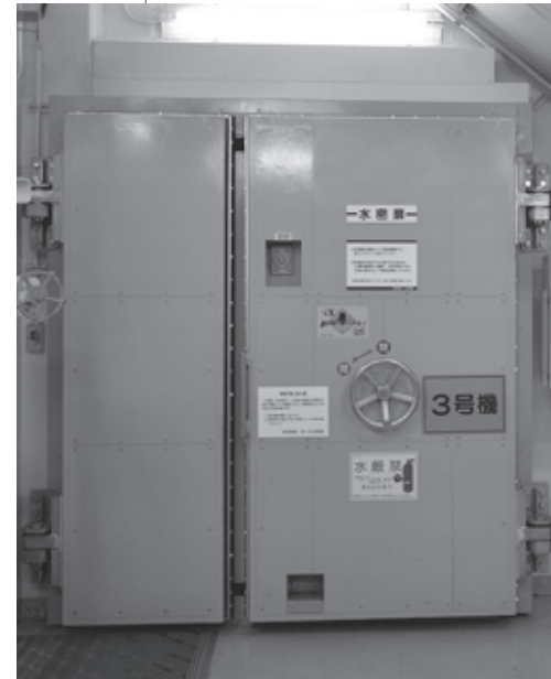
重要設備を浸水から守る水密扉
