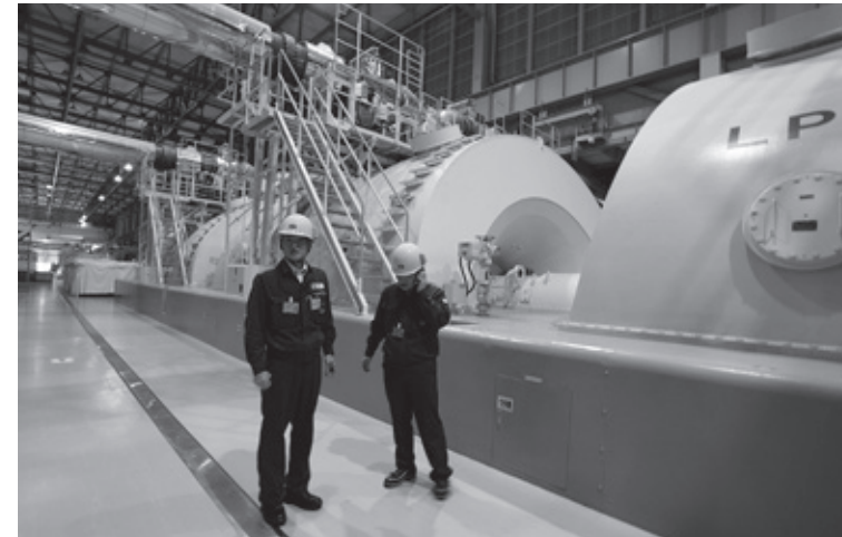
整然としたタービン建屋内。タービン発電機が出番を待っている
