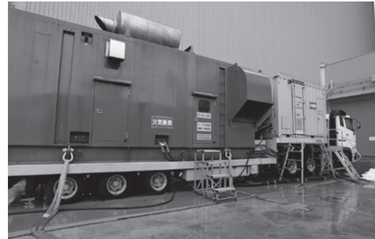
空冷式非常用発電装置。万一の事故が起きたとき、収束に必要な機器の電力を賄う
