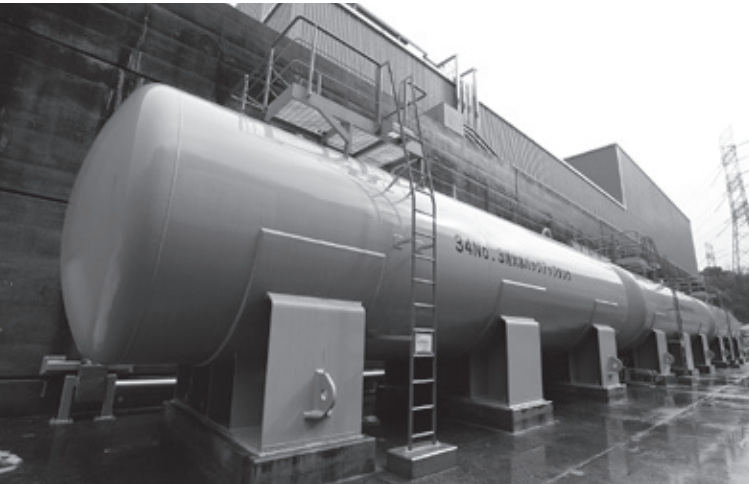
内部火災対策としての消火水バックアップタンク。 700ガルの地震に耐えられる100tタンクを3・4号機用に6基設置
