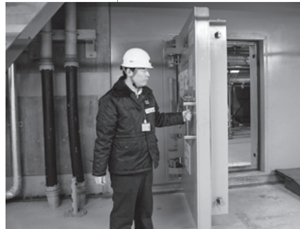
重い水密扉を開けると警報が鳴り続け、中央制御室で確認できるようになっている
