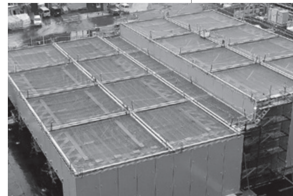
竜巻による飛来物防護対策として重要設備を頑丈な鋼材で覆っている
