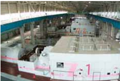
堺港発電所 内部設備
