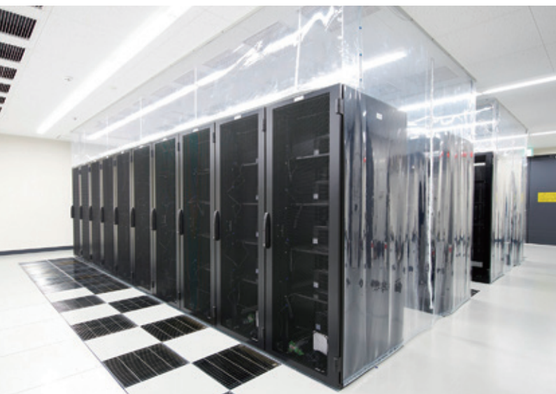
情報通信設備
