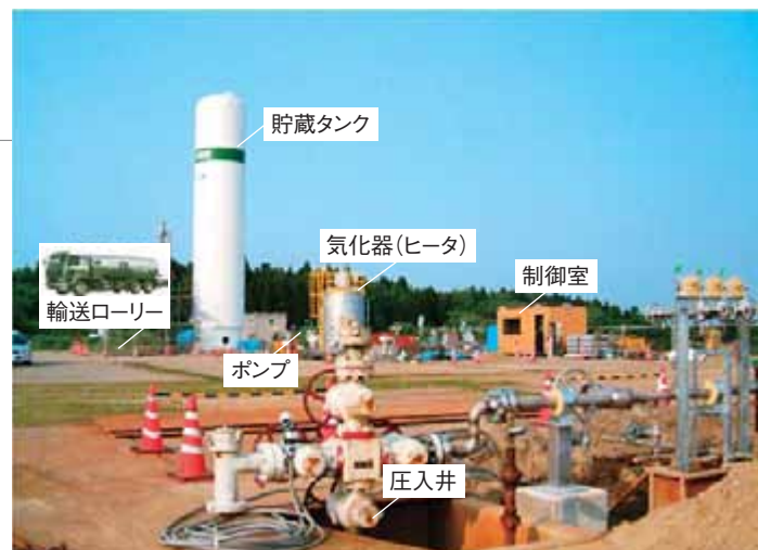
CO 2 地中貯留(新潟県長岡市のRITE岩野原実証試験サイト)
