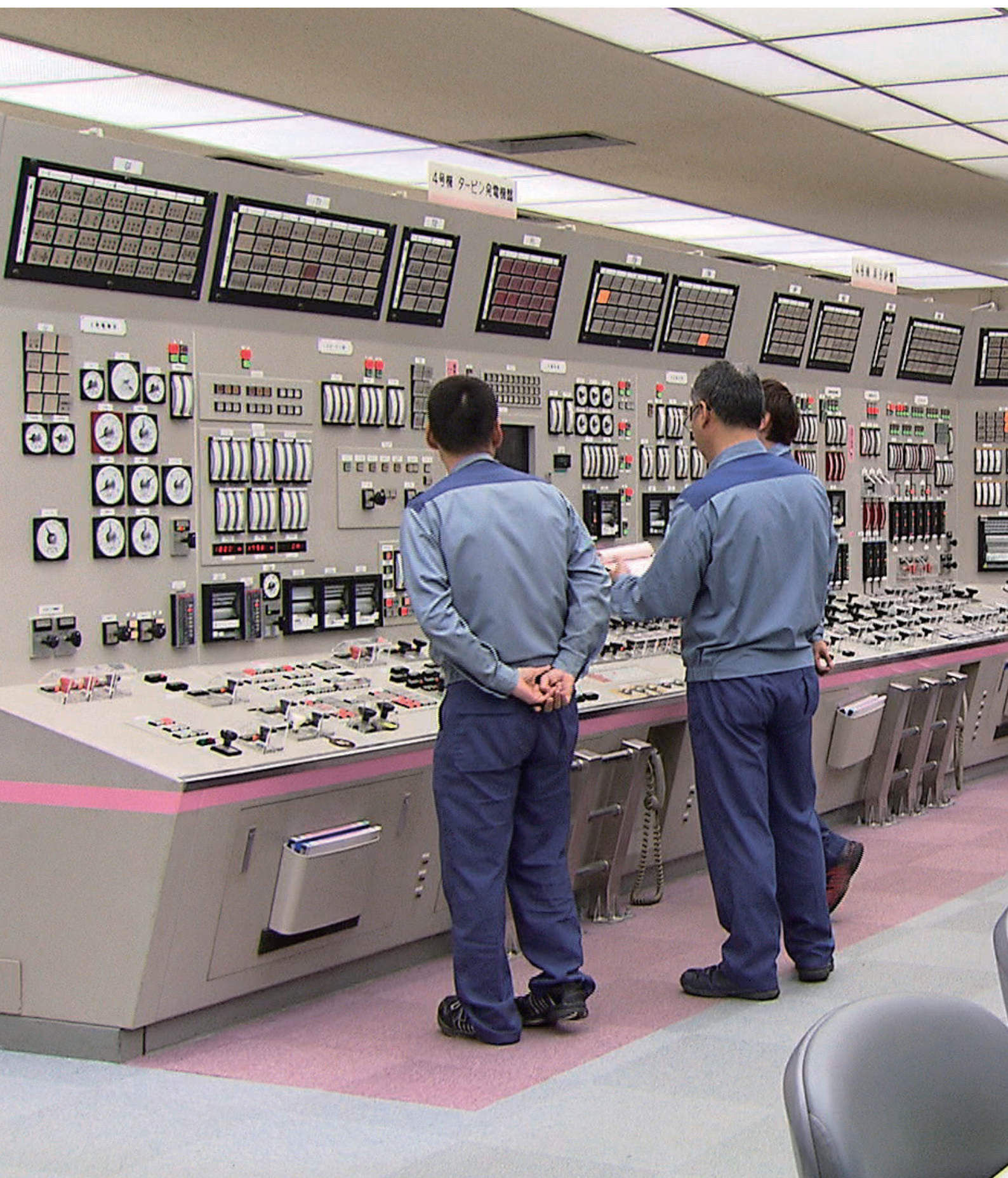
震災後の長期停止を経て運転を再開しつつある原子力発電所。写真は運転再開時の高浜4号機・中央制御室
