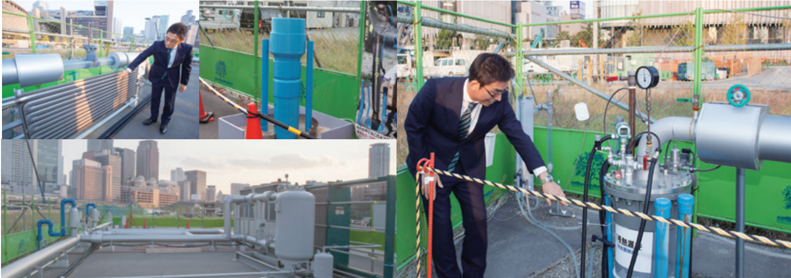
右手前に蓄圧タンクと熱交換器、奥に空冷ヒートポンプ
