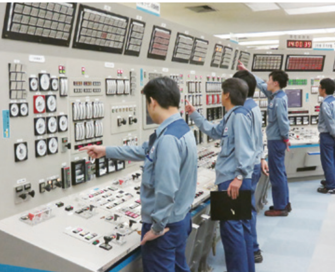
高浜発電所3号機並列（発電・送電開始）時の中央制御室
