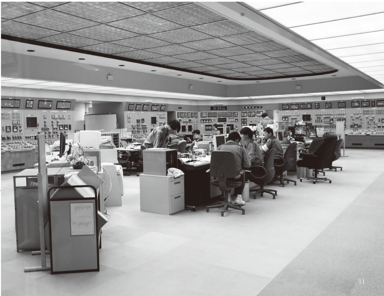
大飯発電所 中央制御室
