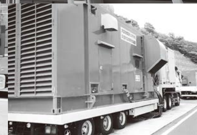
▲万一のときのため電源を多重化・多様化。高台に配備された空冷式非常用発電装置
