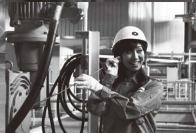
▲異音がないか確認、聴診棒による給炭機の点検
