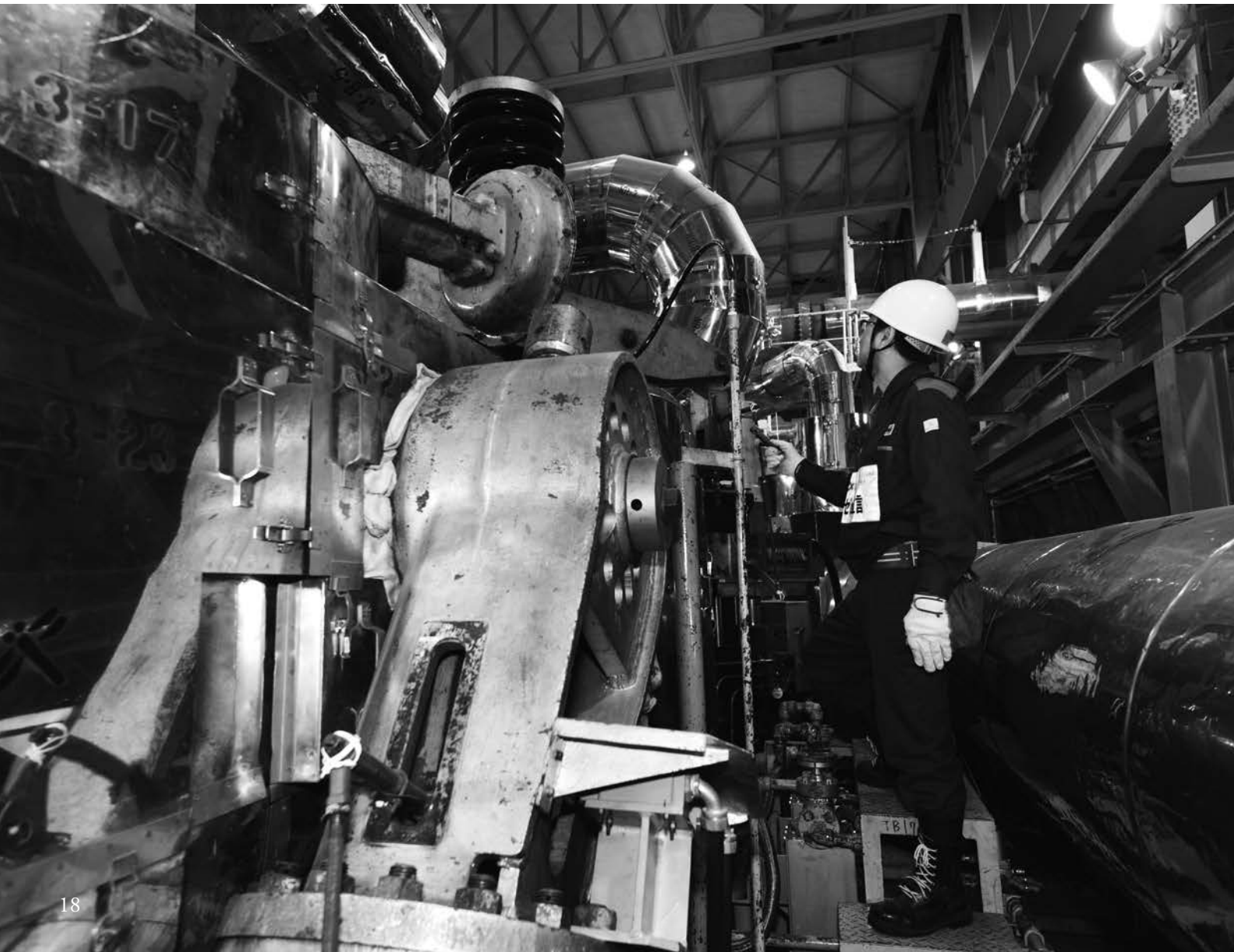
原子力発電所のメンテナンス(美浜発電所)
