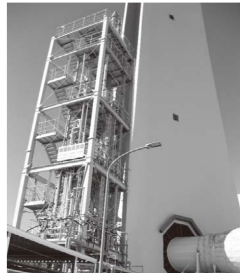
南港発電所の排煙脱炭パイロットプラント
