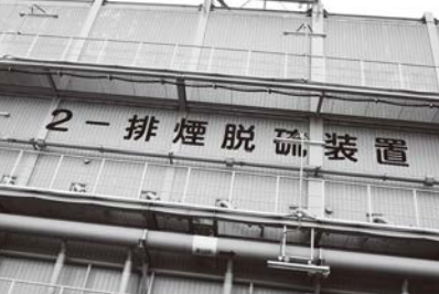
◀排煙脱硫装置
