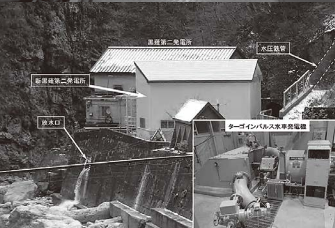
上／石津川変電所蓄電池実証 下／新黒礁第二発電所
