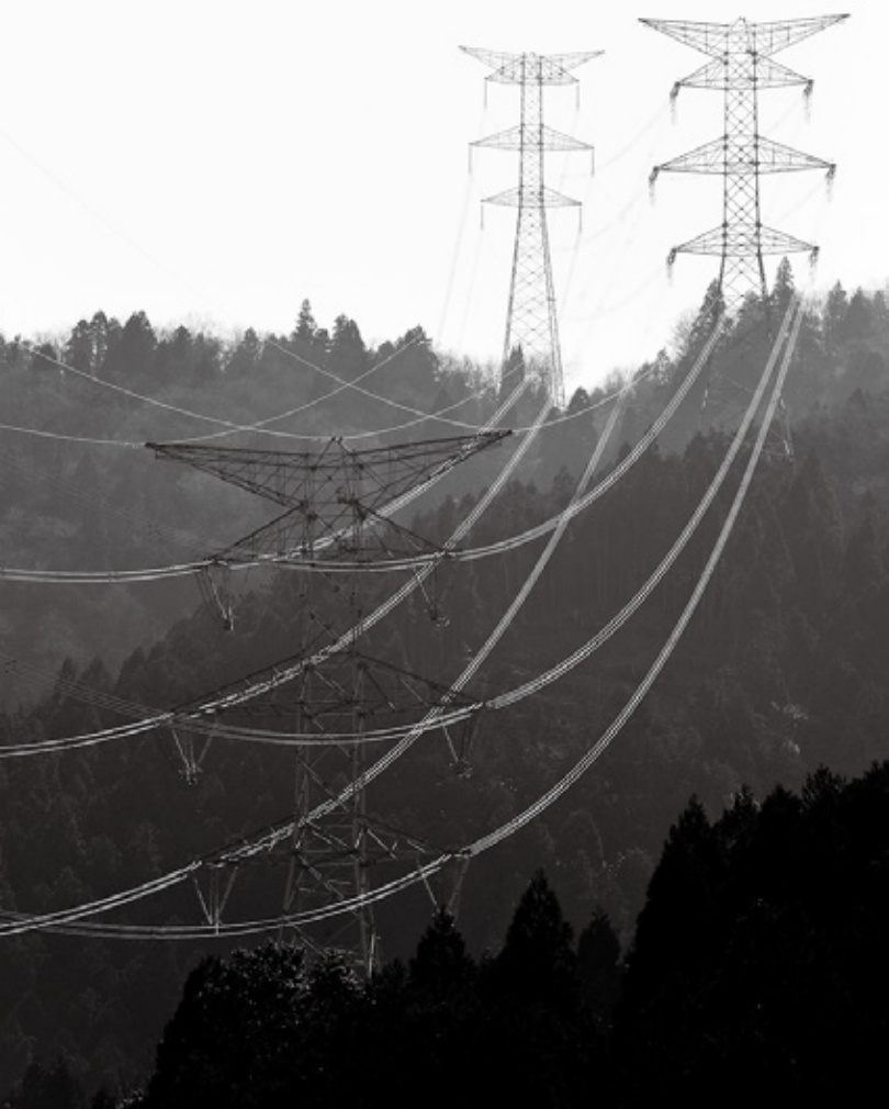
電気の大動脈、送電線/送電鉄塔
