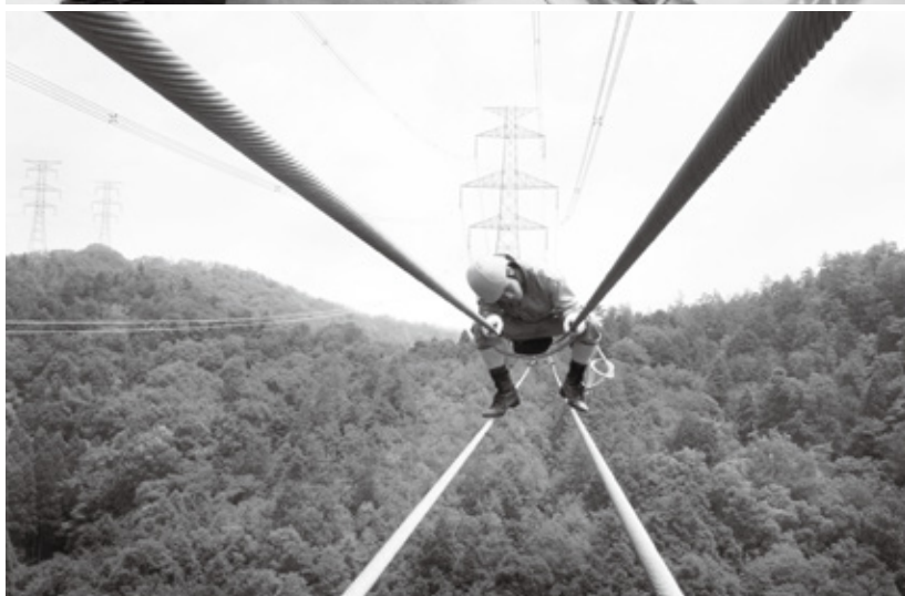
上／巨大な50万V変圧器の点検 中／地中送電、電力ケーブルの点検 下／電線宙乗り点検
