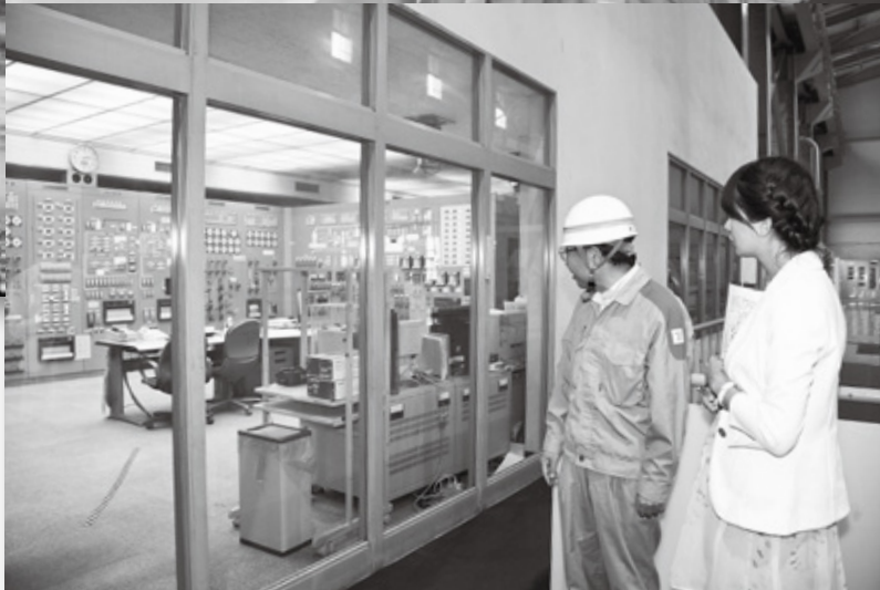
▲建屋内の制御室。運転操作は、2km離れた大岳発電所から遠隔制御しているため、ここには人はいない
