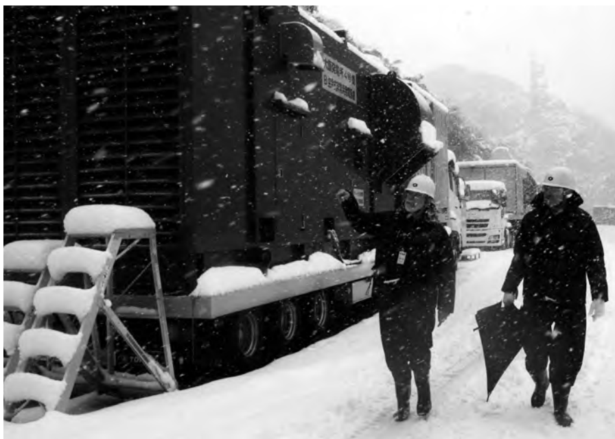
2012年1月にはストレステストの適切性を確認するため、IAEAの調査団が関西電力・大飯発電所を視察。空冷式非常用発電装置などを確認した ©Greg Webb/IAEA
